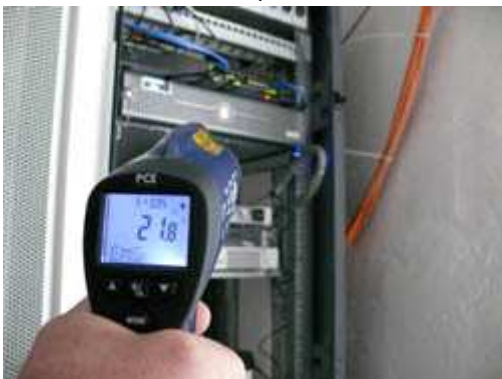
Realizzando una misurazione in un quadro di controllo col termometro infrarosso.
