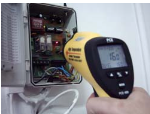
misurazione in un quadro di controllo col termometro infrarosso.
