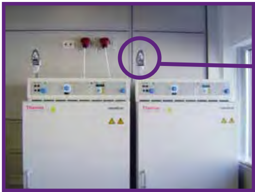
Controllo della temperatura su Stufe
